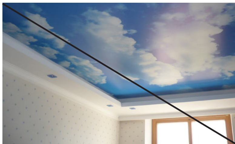
Плохо Натяжные потолки. Потолки с рисунками
